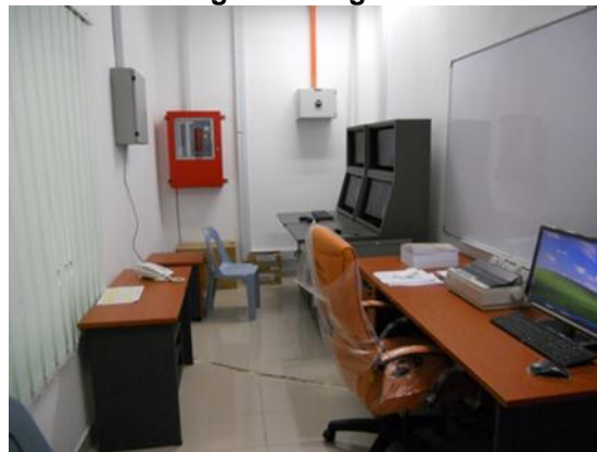
Gambar 2.2 Bilik Kawalan CCTV Yang Tidak Digunakan
