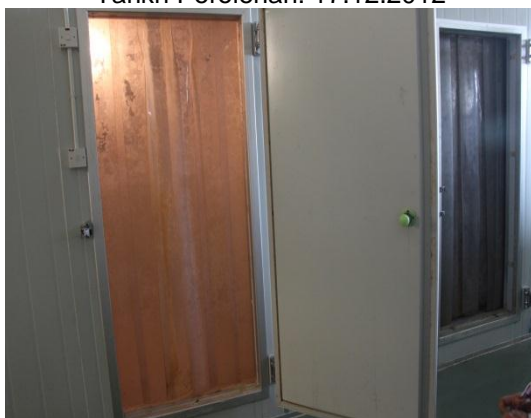
Gambar 1.10 Aset Yang Tidak Digunakan Blast Freezer, Cold Room, Chiller Room Harga Perolehan: RM187,000 Tarikh Perolehan: 17.12.2012
