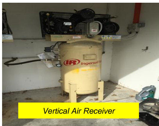
Gambar 4.15 Keadaan Vertical Air Receiver Yang Rosak Semasa Pemeriksaan JKPP
